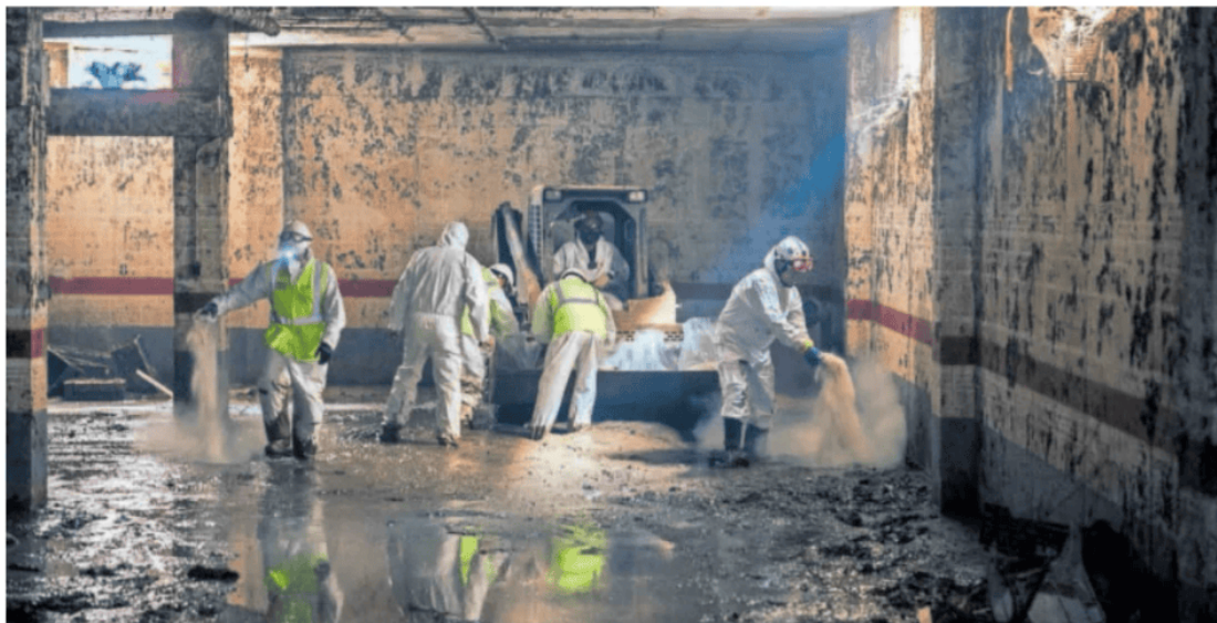
Labores de limpieza de lodo en un garaje de uno de los municipios valencianos afectados por la dana. ÓSCAR CORRAL
